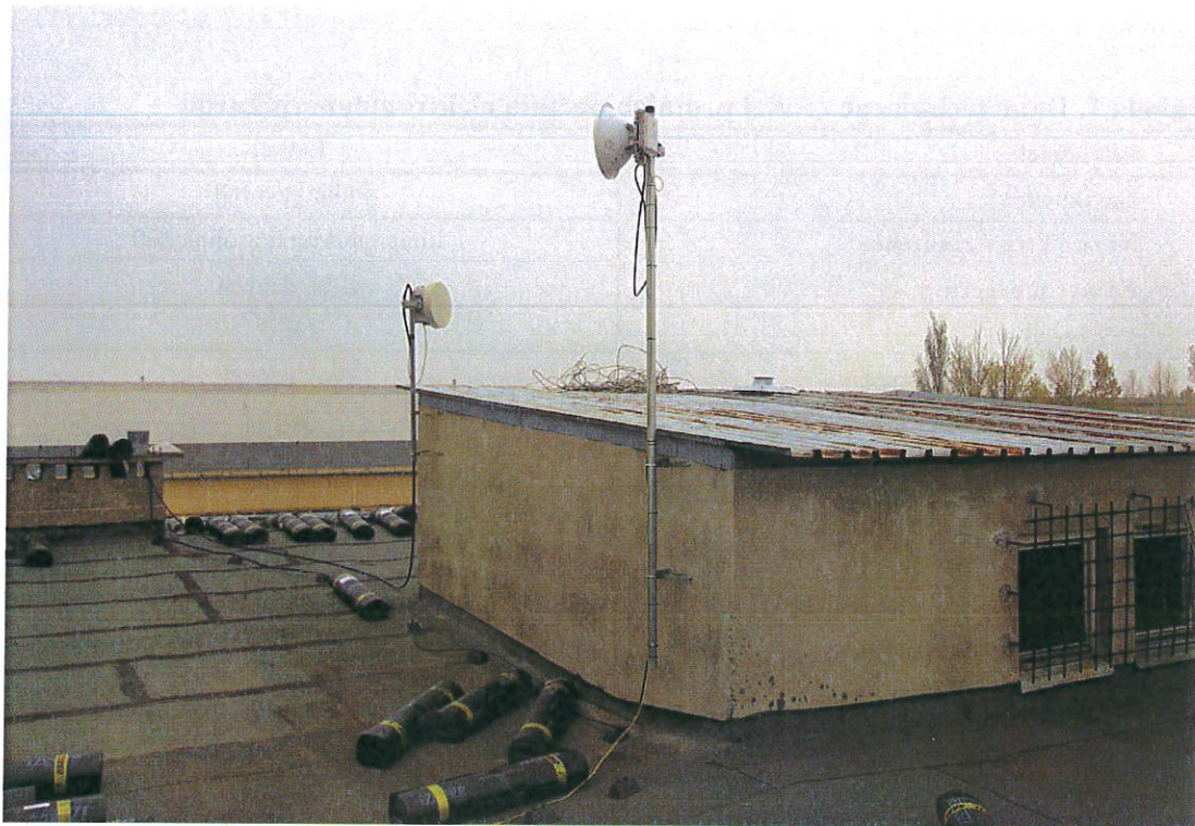
Fot. 1. OM Skierniewice / ul. Przemysłowa – widok anteny linii radiowej Emitel na dachu budynku
